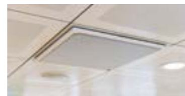
Deckenmikrofon RM-CGW an der Decke des Sitzungssaals installiert
